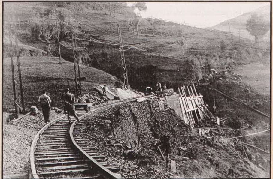
Reparando un desprendimiento. En primer plano puede observarse una mesilla. (Foto cedida por Euskotren-Museo Vasco del Ferrocarril. Azpeitia).
