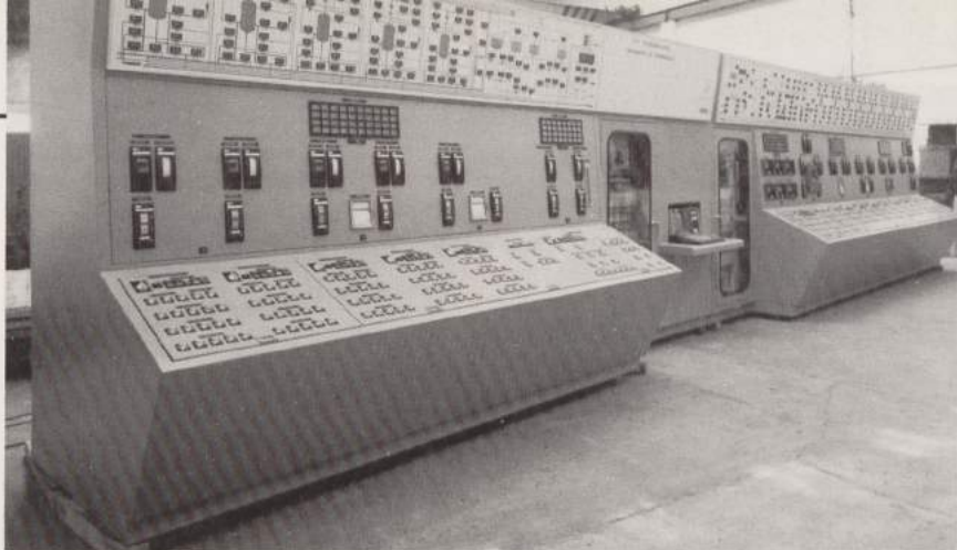
Tratamiento de condensados en central nuclear de Valdecaballeros. Panel de mando fabricado por Bihar.
