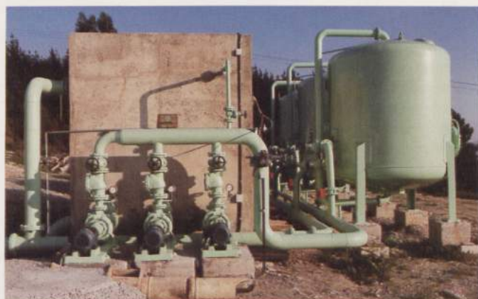
Filtración sobre carbón activo para potabilización de agua en la planta de Mungia (Ondoan).
