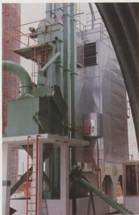
Instalación de secado de maíz fabricado por Funcor
